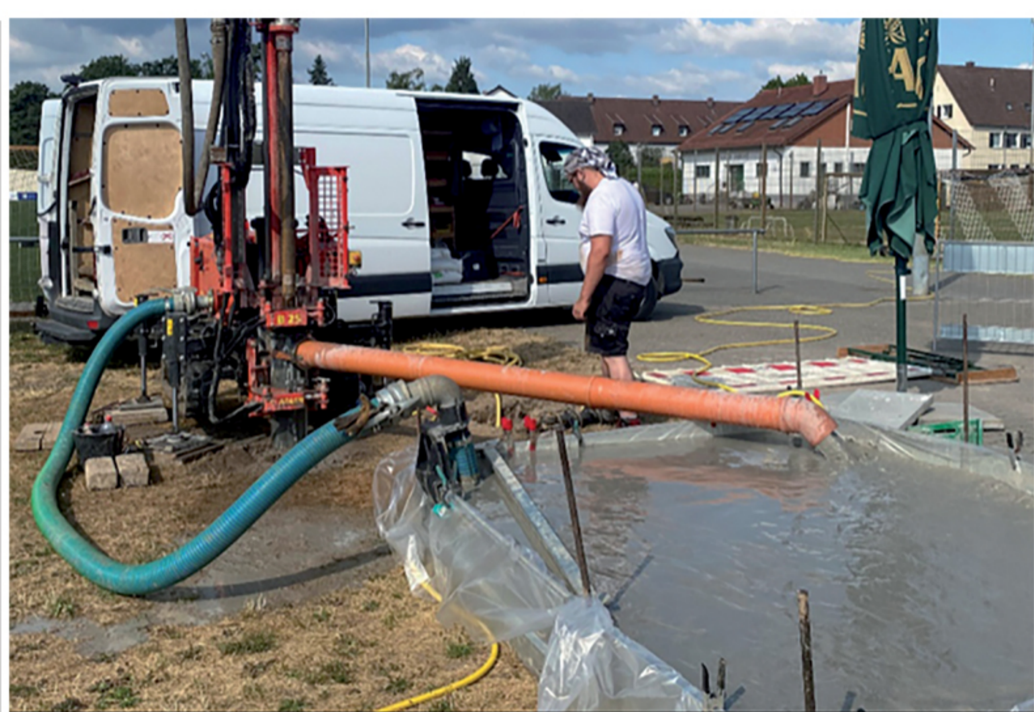
Das Großprojekt Bewässerungsanlage wurde durch den Ausfall der Brunnenanlage notwendig und mit Bravour von der Arbeitsgruppe der Senioren gemeistert. Es war aber auch ein immenser Kostenpunkt.
